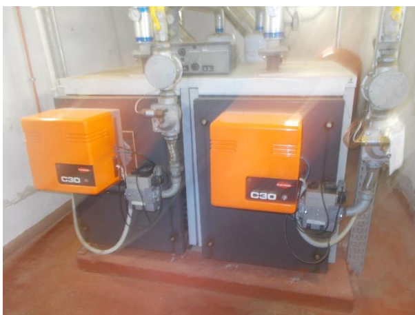
Figura 4.8 - Particolare dei generatori
