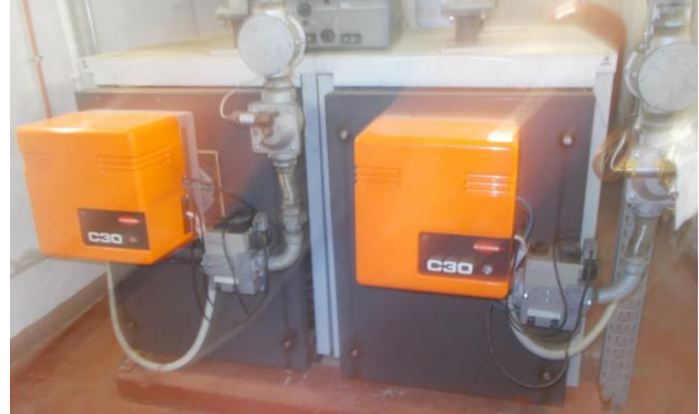
Figura 8.4 – Particolare delle caldaie
