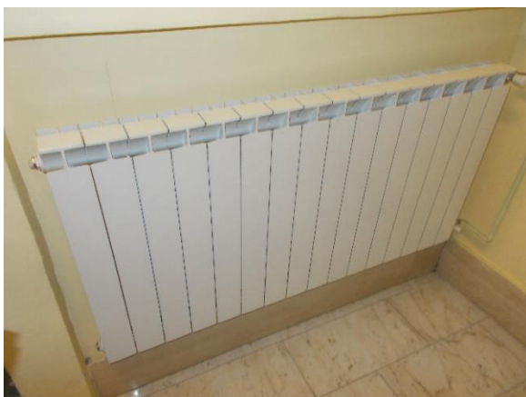
Figura 4.6 – Particolare dei radiatori
