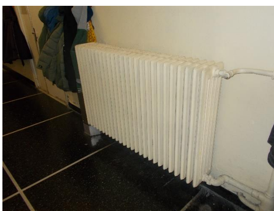
Figura 4.7 - Particolare dei radiatori
